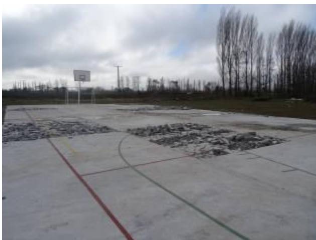
Foto 1-C: Falla estructural en multicancha.
